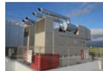
非常用自家発電装置
