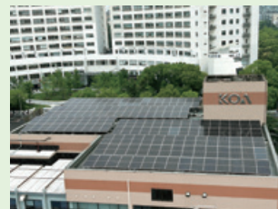
上海興亜屋上のソーラーパネル
