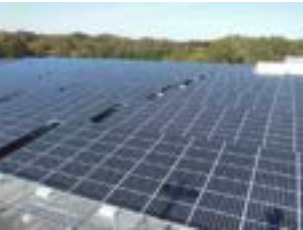
エルナー白河太陽光発電所
