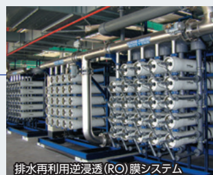
排水再利用逆浸透 (RO) 膜システム
