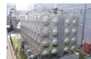
バッチ式最終放流槽
