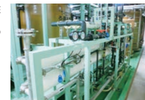
純水製造装置
