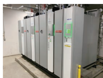
空調熱源用のボイラー
