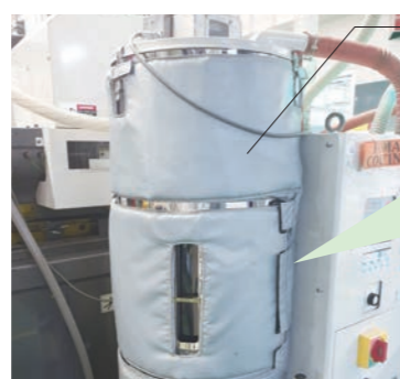
断熱材を設置した材料乾燥機
