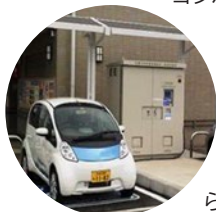
太陽光発電・蓄電池併設型EV用急速充電設備 2011年電設工業展製品コンクール 環境大臣賞受賞
