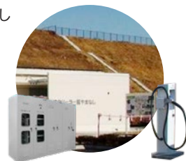
山梨県米倉山メガソーラーPR施設に設置 「創エネ」と「蓄エネ」型エネルギーマネジメントシステム JECA FAIR2012製品コンクール 再生可能エネルギー促進賞受賞
