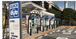
大黒パーキングエリアに設置された200kW出力EV・PHV用マルチ急速充電器
