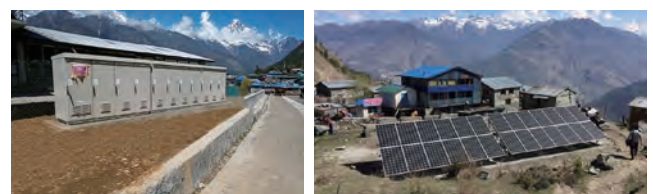
テンジン・ヒラリー空港（旧ルクラ空港）の太陽光発電・蓄電システム
