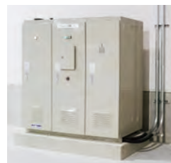
公共・産業用蓄電システム
