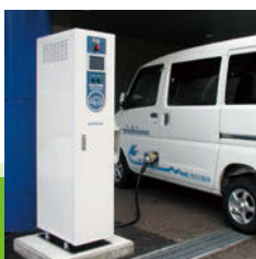
EV用急速充電器
