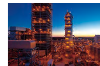
CO 2 回収プラント（世界最大のCO 2 回収量4,776トン/日）
