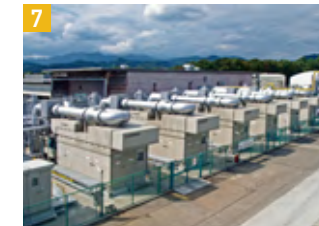
7 高効率ガス発電システム
