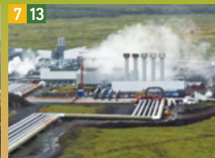
7 13 地熱発電プラント
