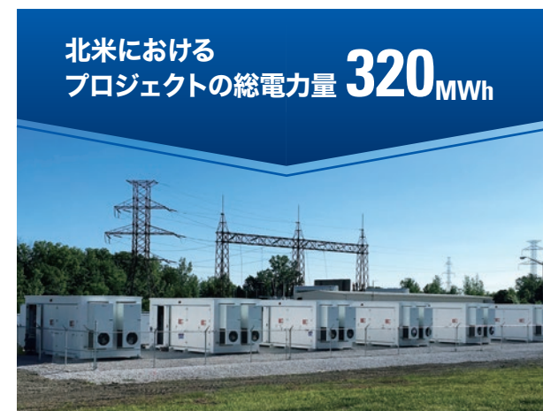
オンタリオ州サーニアでのプロジェクト（蓄電池）
