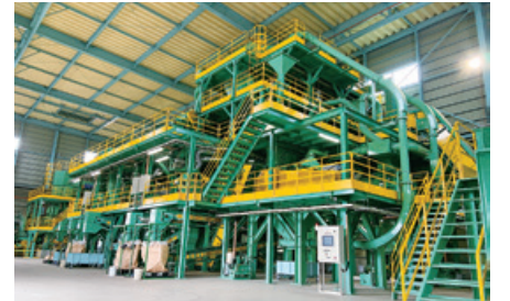
ダスト破砕選別設備
