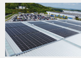
幸田工場の太陽光パネル
