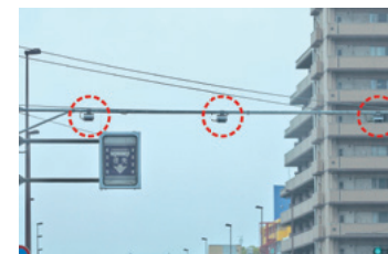
福岡市内に設置された高度化光ビーコン
