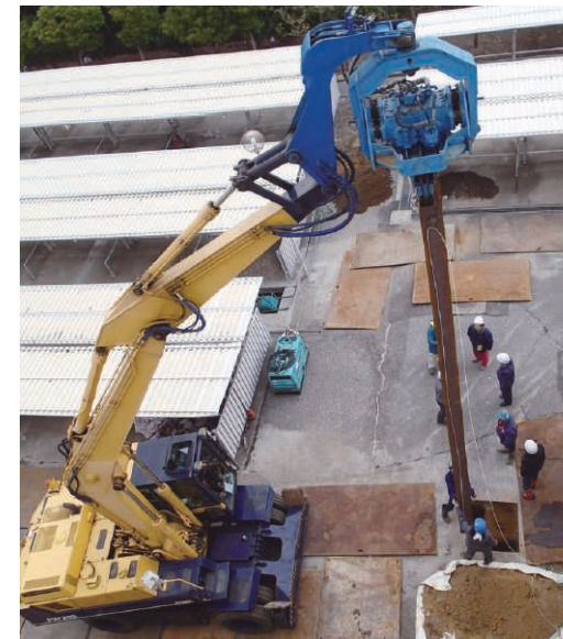
施工の様子 (重機とパイロハンマーを使ったACEライナーの打設)
