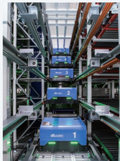
ユニチャトル(高速自動入出庫装置)
