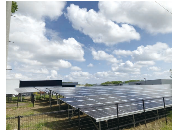
小山ファクトリーの太陽光発電パネル
