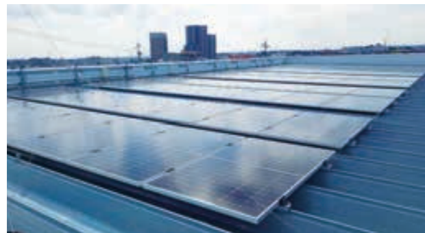
愛知県刈谷市富士見店の屋上に設置した太陽光パネル
