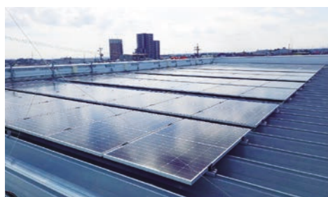
愛知県刈谷市富士見店の屋上に設置した太陽光パネル
