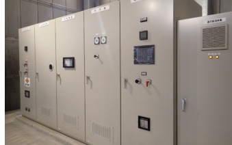
高圧系統連系盤・発電機制御盤など
