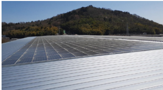
APセンター屋上に設置した太陽光パネル
