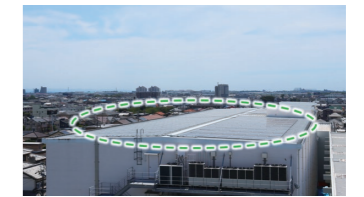
SLC浜松西の屋上に設置した太陽光パネル
