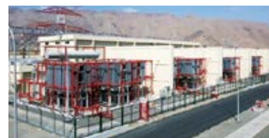
固定式変電所イメージ((株)東芝提供)
