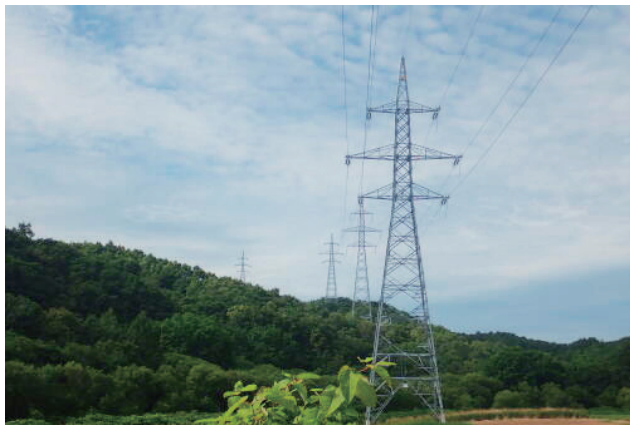
北海道北部風力送電（株）が整備した約78kmに亘る送電設備
