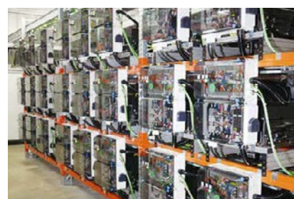
The Mobility House 社が運用する大型蓄電システム
