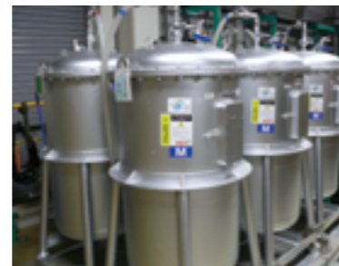
純水リサイクルシステムの一部
