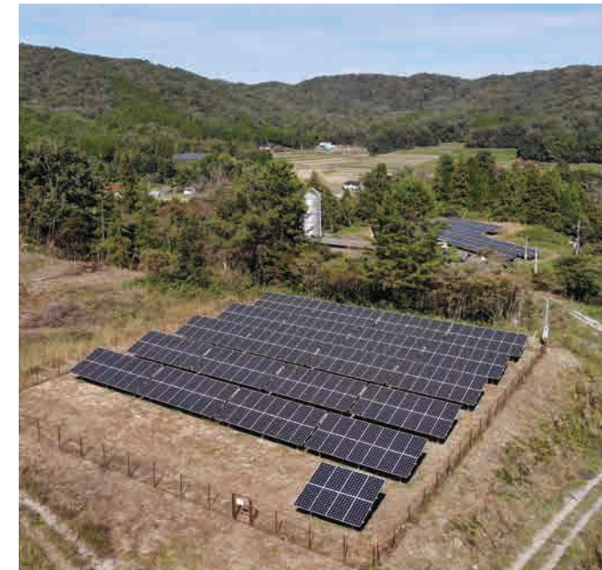
ウエストホールディングスが手掛けた太陽光発電設備
