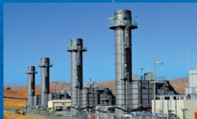
DGCが100% 保有するカリ フォルニア州 Mariposa火 力発電所
