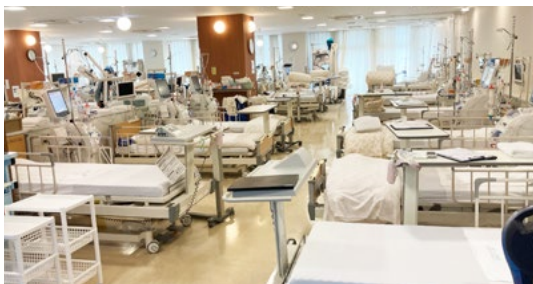
医療施設におけるLED照明の導入
