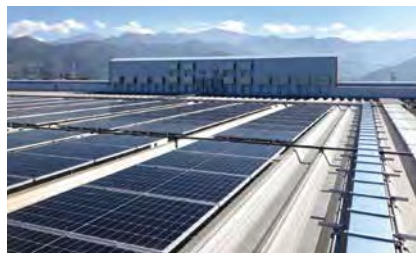
店舗の屋根に設置した太陽光パネル
