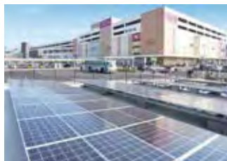
太陽光パネルを設置
