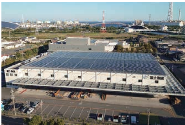
太陽光発電システムの第三者所有 (PPA) モデル 富士物流「三重物流センター」
