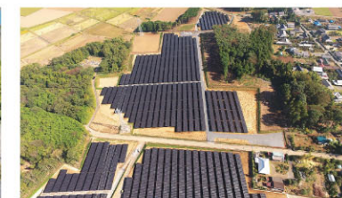
LS桜川中泉発電所(茨城県桜川市中泉)
