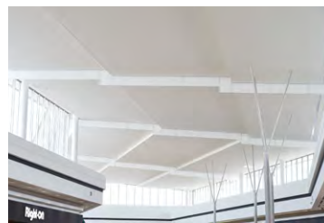
軽量素材や耐震用器具を用いた「特定天井」。大きな揺れにも対応できる
