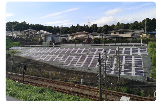
弥生台駅の太陽光発電設備
