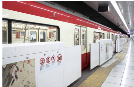
羽田空港国際線ターミナル駅に設置しているホームドア
