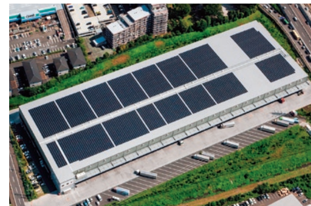
太陽光発電所（東部海老名物流センター）
