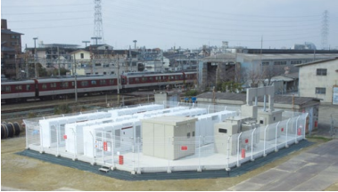
大規模蓄電池
