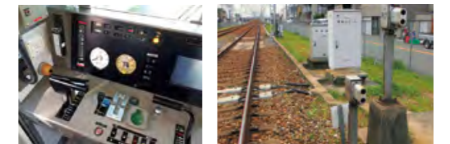
運転士異常時列車停止装置 踏切障害物検知装置・発光器・受光器
