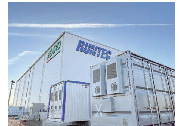
太陽光発電設備、大容量蓄電池を備えた(株)ランテック 宮崎支店
