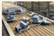
屋根上への搭載状態
