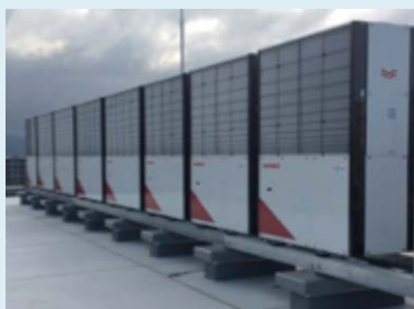
「SJR六本松」に導入されたガスエンジンマイクロコジェネレーションシステム
