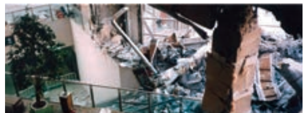
阪神・淡路大震災被災状況(神戸・ハーバーランドダイヤニッセビル)
