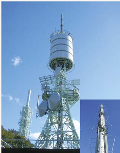
弥彦山頂に設置されたFM送信設備 (右下は拡大写真)
