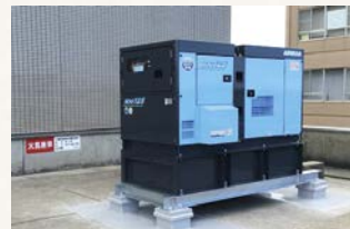
非常用発電機
