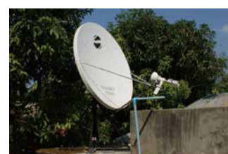
寺子屋に設置されたVSAT (小型地球局)
