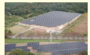
NTTアノードエナジー発電所(鳥取市)
