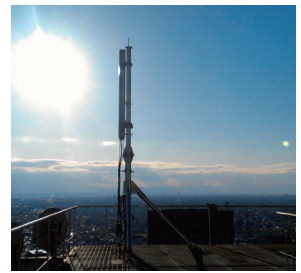
KDDI新宿ビル屋上に設備された大ゾーン基地局アンテナのひとつ
