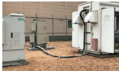
本年完成した燃料電池試験環境
